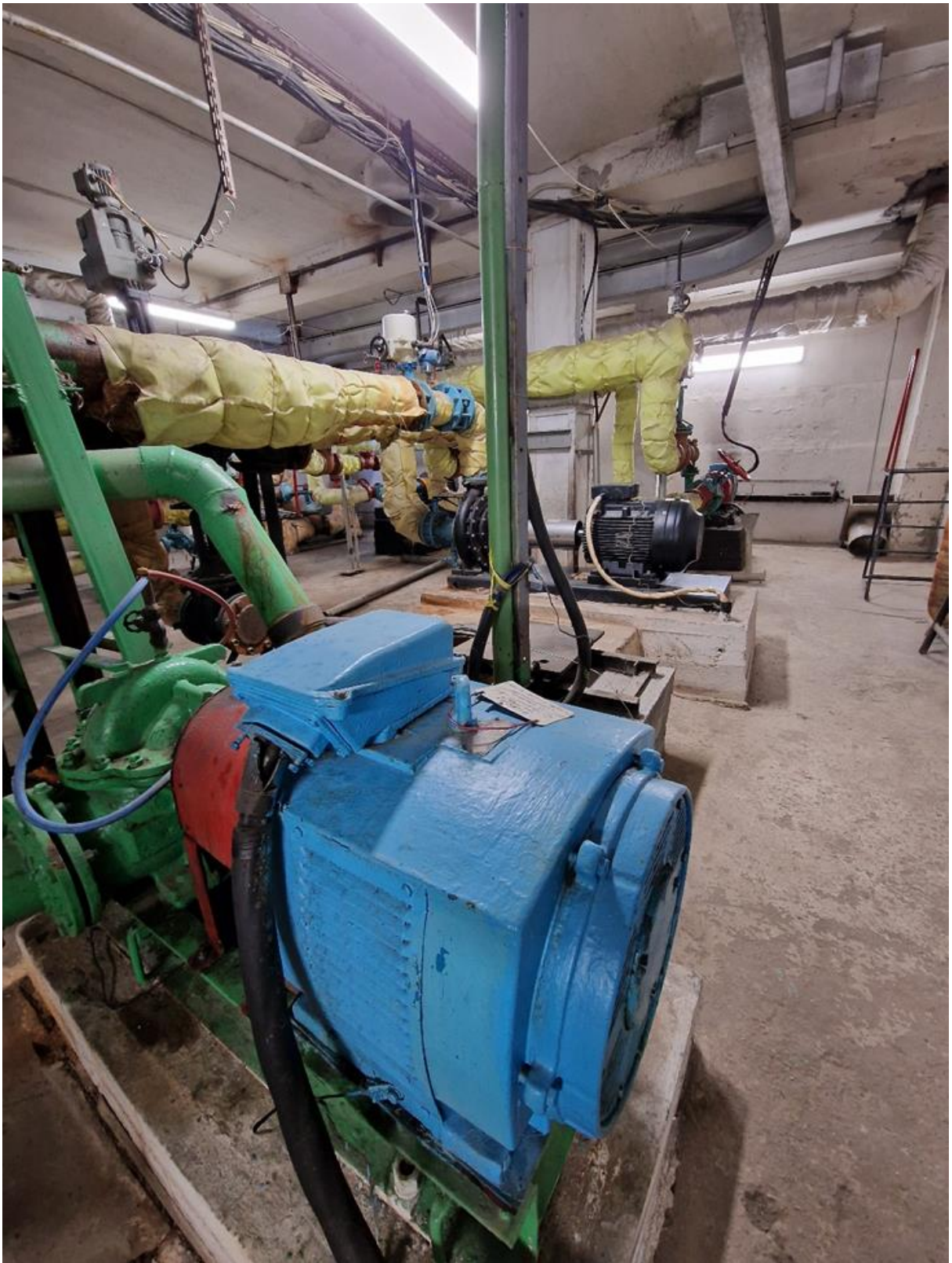
Рисунок 17. Машинный зал НС «Энергоблок».
